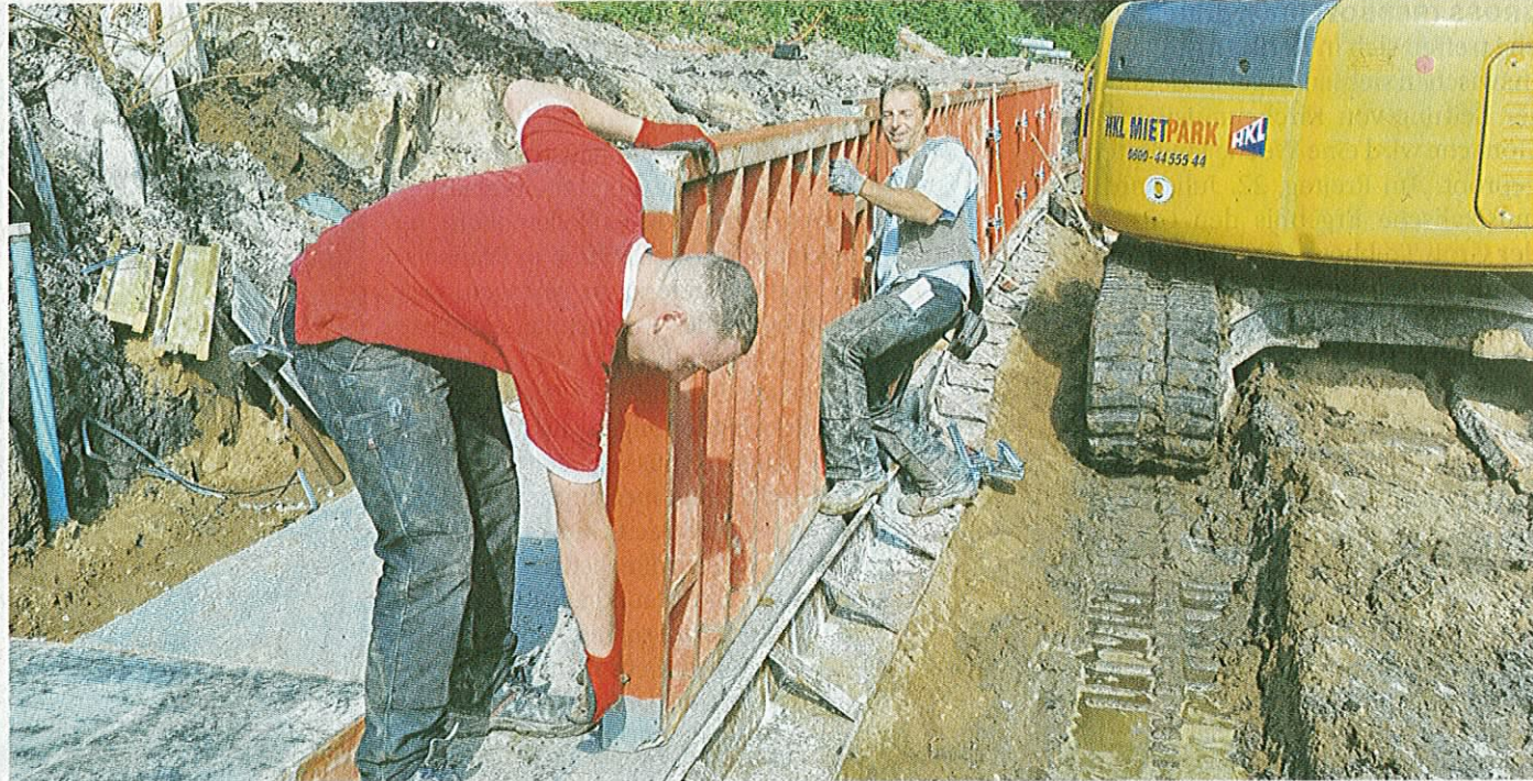
Gründungsarbeiten: Christian Mikula und René Stüdemann von der Leezener Firma Matthäi bauen eine Spundwand auf, mit deren Hilfe wird eine der Grundswellen aus Beton gegossen. FOTO: WERNER METT
