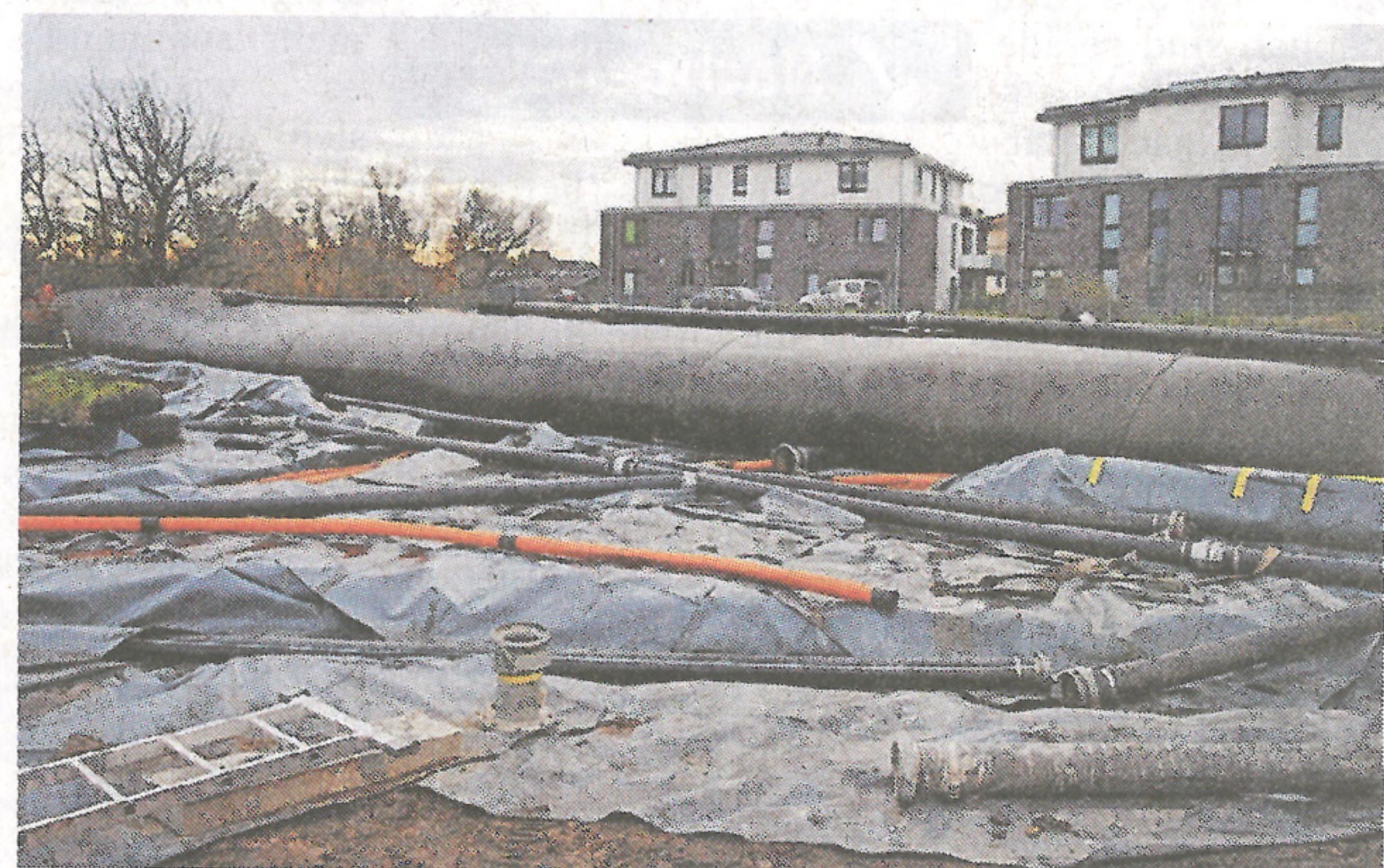
In diesem Sack „blutet“ der Sand aus, das Wasser läuft zurück in die Este. Dann wird der Sack aufgeschnitten, Lkw holen das Baggergut ab.
