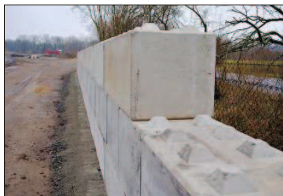
Um das Betriebsgelände in Hohenwulsch wird derzeit eine neue Einfriedung aus Betonblocksteinen erstellt.
