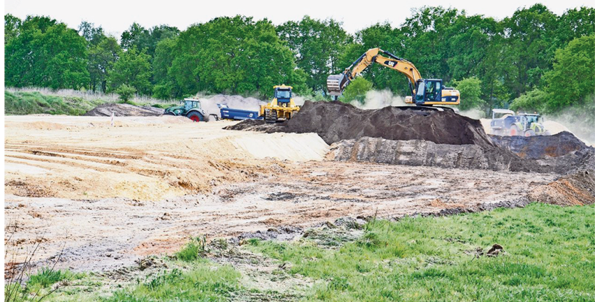
Sechs Hektar misst das Grundstück, auf dem derzeit Mutterboden abgetragen und Sand für den Kabellagerplatz aufgefahren wird.
