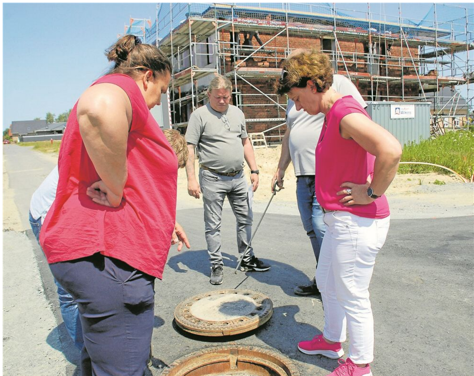
Der Regenwasserkanal lässt bei der Inspektion tief blicken. Foto: Laudien
